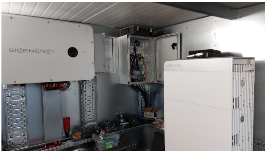
Fot. Widok magazynu energii
