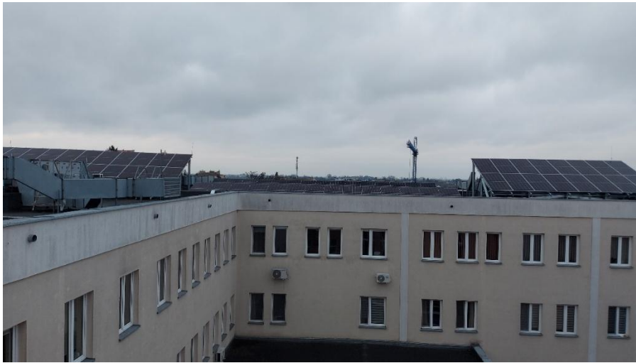
Fot. Widok paneli fotowoltaicznych na dachu.
